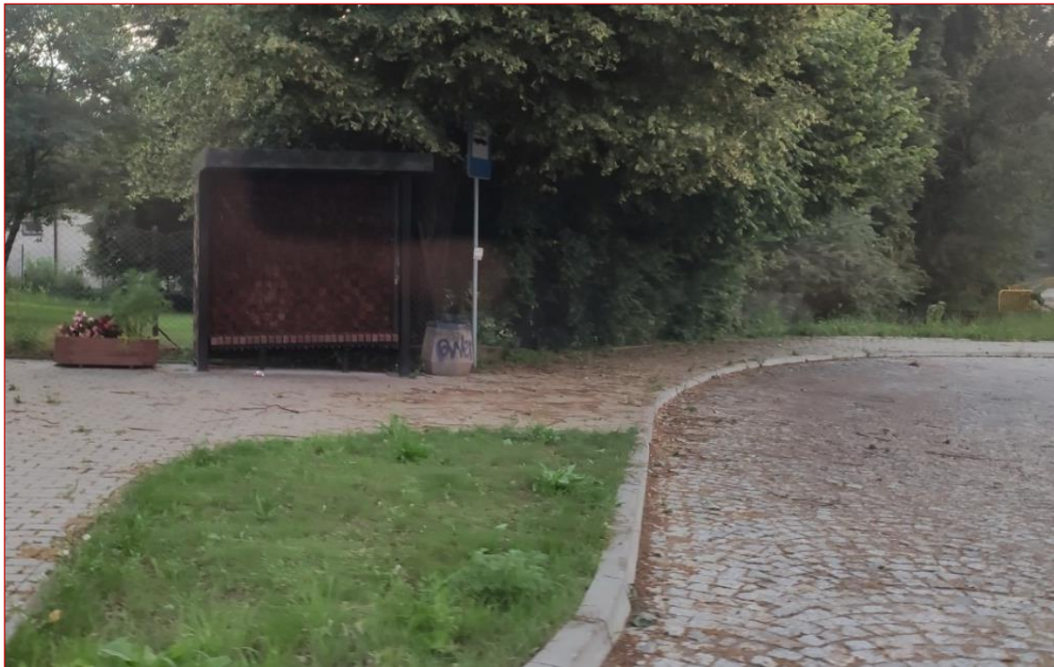
Rysunek 7.7 Inny przykład infrastruktury punktowej wymagającej modernizacji
